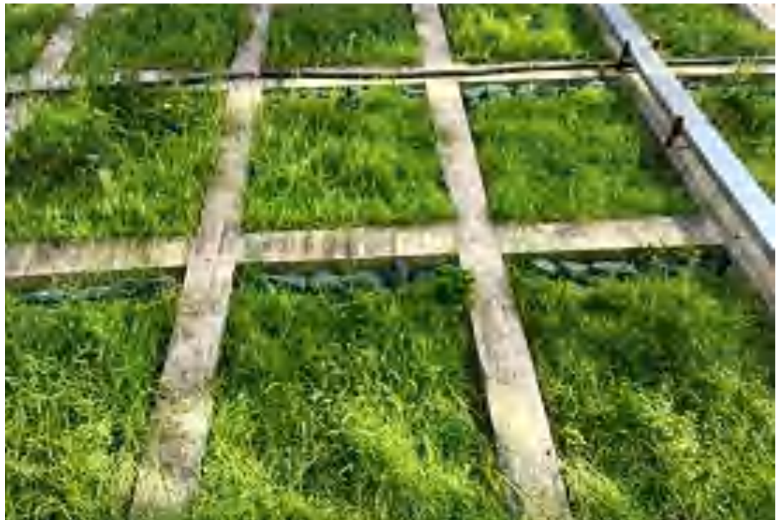
采选矿工业厂区框格植草护坡
