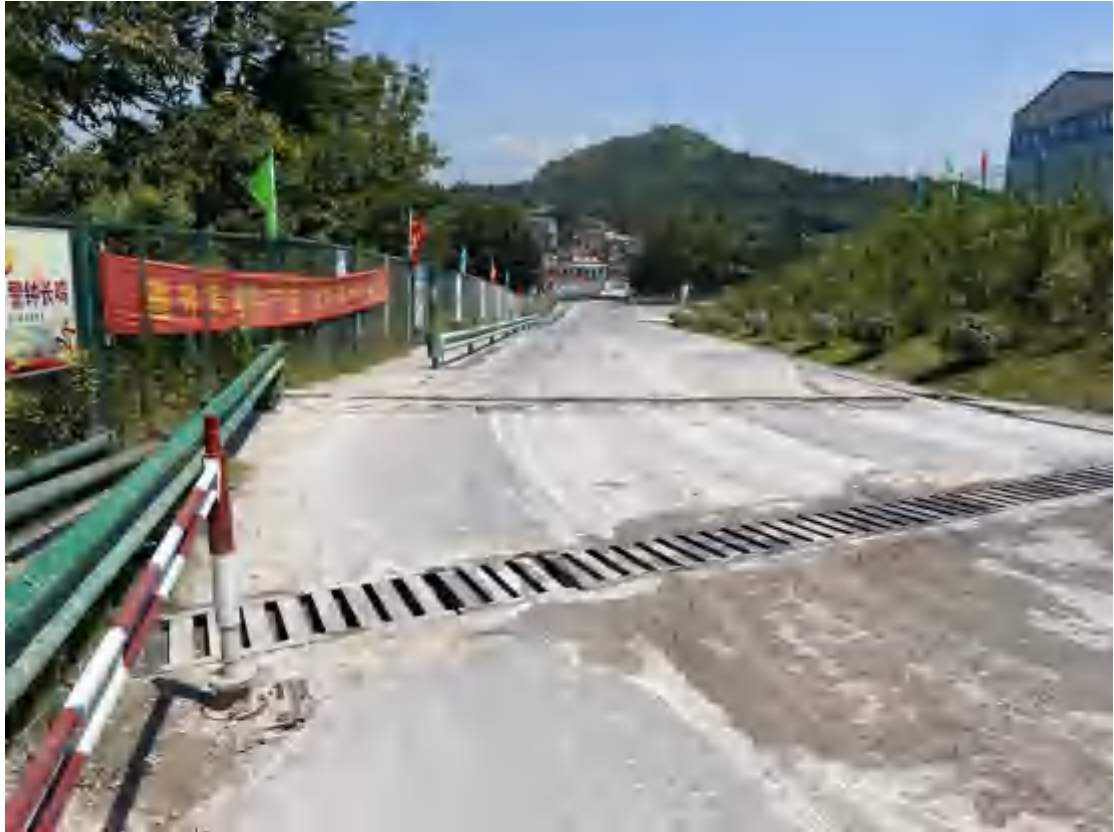
厂外道路区截排水设施
