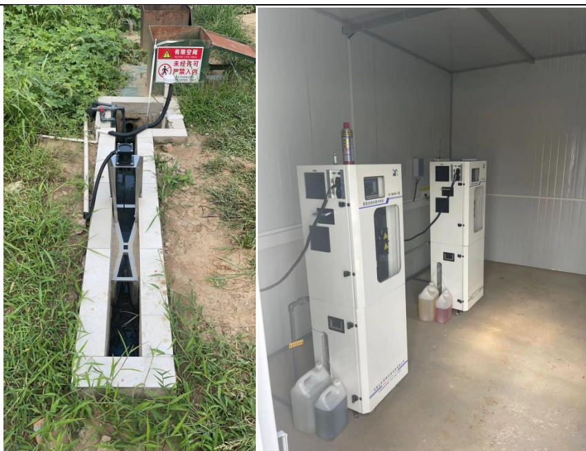
图3-1 地埋式一体化污水处理站、排放口、自动监测设施
