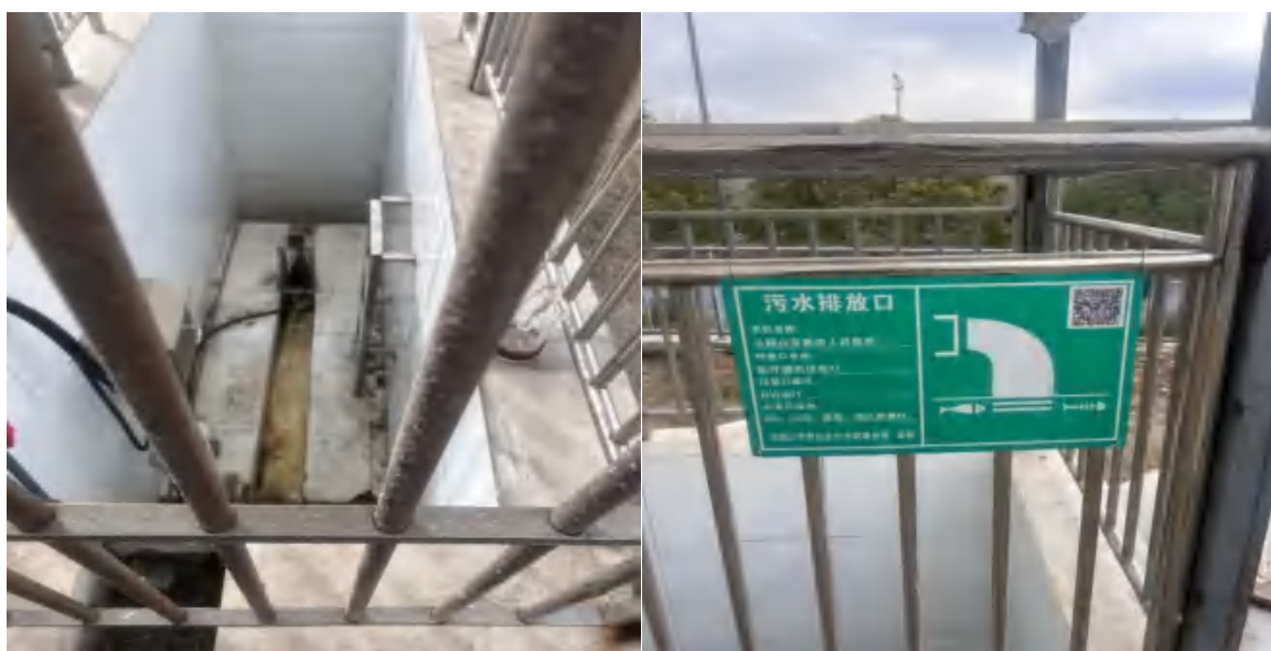
图8 项目废水排放口
